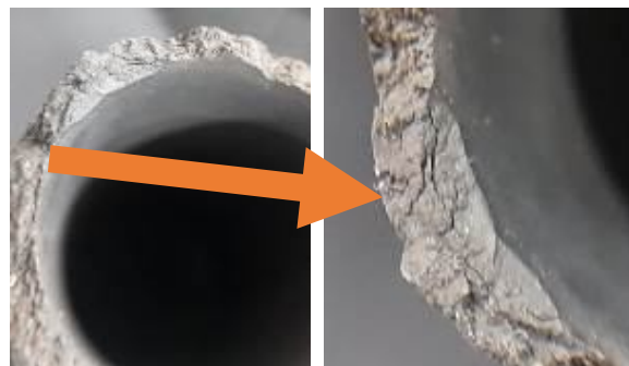
Foto 06 - Vista da superfície de ruptura da região do tubo, com indicação do início do dano, com deformação.
