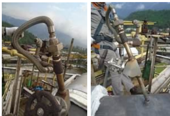
Foto 09. Detalhe da região onde houve o início da ruptura, indicando o lado posterior a instalação da mangueira flexível, instalada na extremidade do tie-in.
