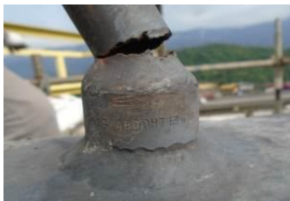
Foto 02 – Detalhe da ruptura na região da solda de instalação do tie-in (sockolet x Tubo de 3/4").
