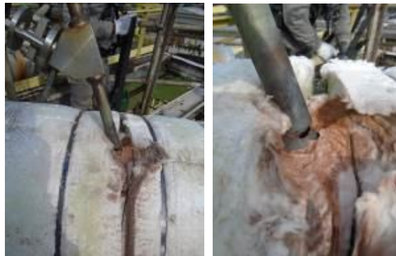
Foto 03, Detalhe da região onde houve o início da ruptura, e remoção do isolamento térmico ao seu entorno.
